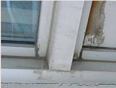
Agrietamientos por mala resistencia y calidad
